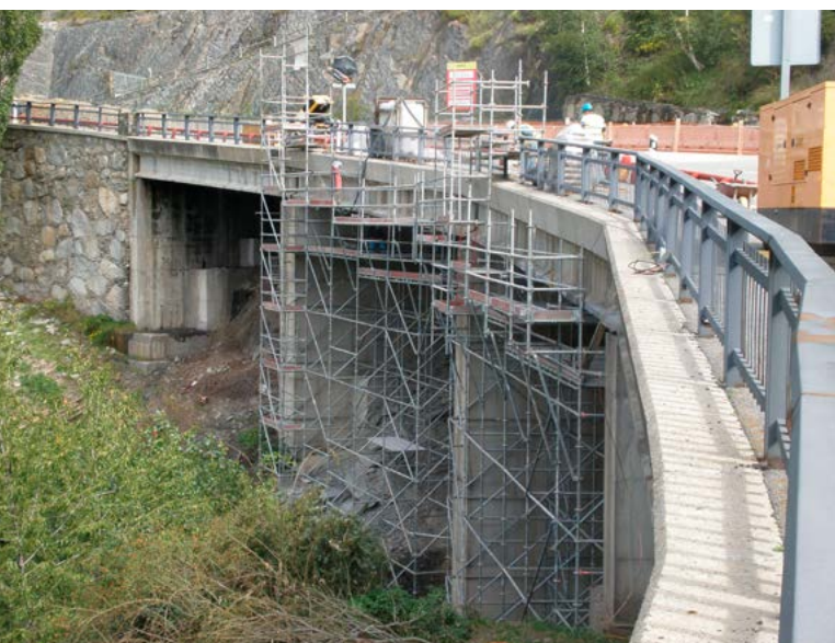
>>> Vista general del viaducte amb les bastides pel desenvolupament dels treballs de rehabilitació
