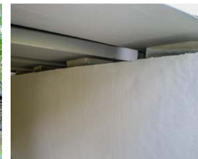
2. Suport ja reparat amb morters de reparació i pintats amb una protecció impermeabilitzant amb resines acríliques, que preservará el suport de formigó.
