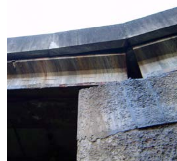
4. Lateral del viaducte, on s'observa el mur carregador, les bigues prefabricades i la imposta erosionada per les sals fundents.
